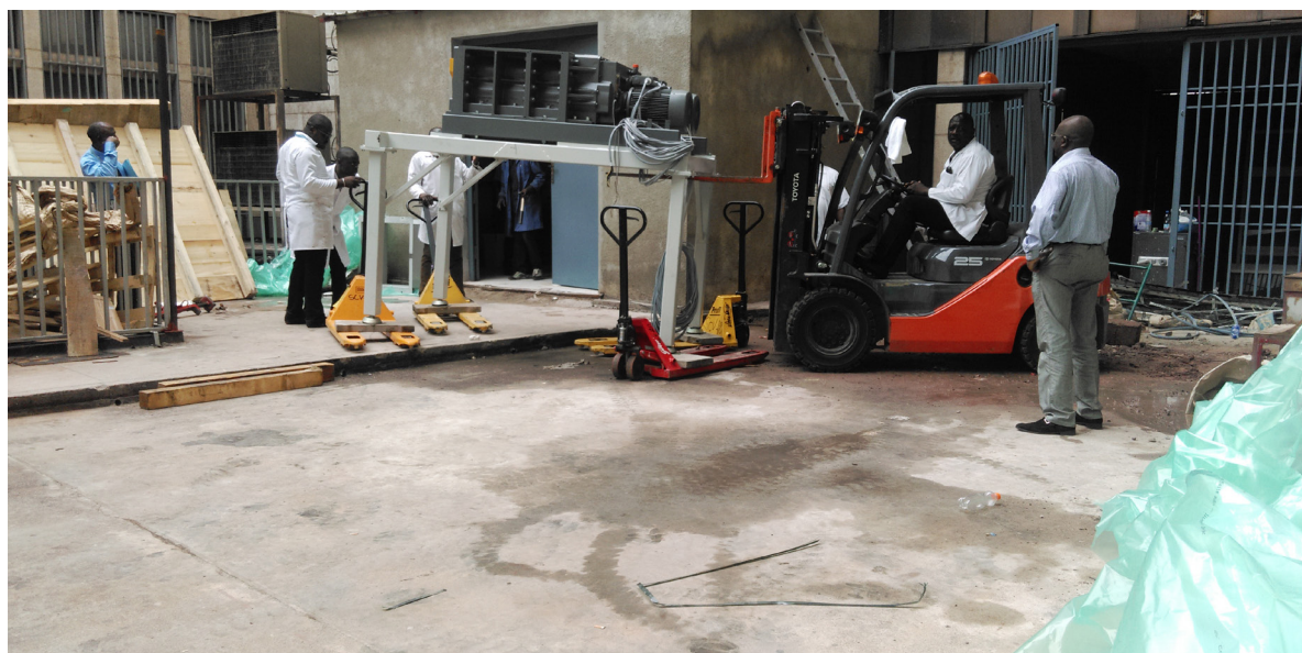
Après la première installation de destruction des billets de banque pour Kinshasa, la Banque Centrale du Congo a commandé une deuxième installation pour le site Lubumbashi, au sud-est du pays.
