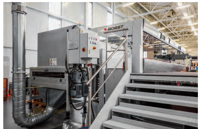
Im Competence Center in Mex können zurzeit vier Stanzmaschinen an das Entsorgungssystem angeschlossen werden.
